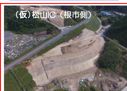
(仮)松山IC(根市側) (仮)松山IC(根市側)では切廻し道路の盛土を行っています。
