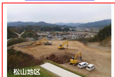
松山地区 松山地区で山を掘削して土砂を搬出しています。
